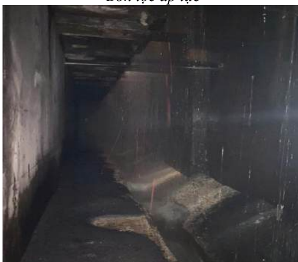
Rãnh thu gom nước thải khu vực cán thô
