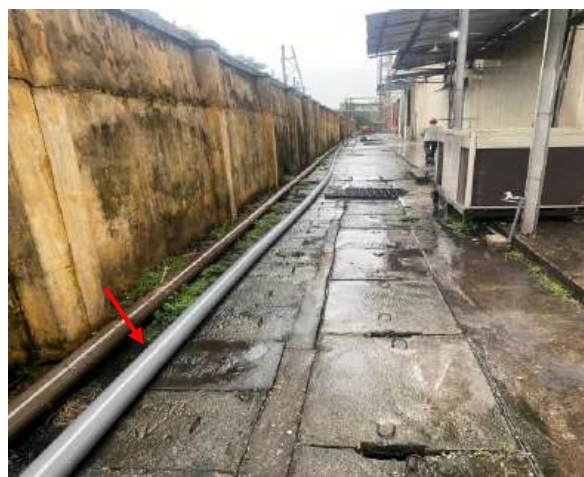
Ống D110 thu gom nước thải về bể tách xỉ
