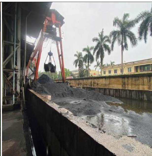
Bể chứa xử thải của nhà máy
