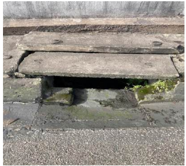
Hố ga thu nước mưa
